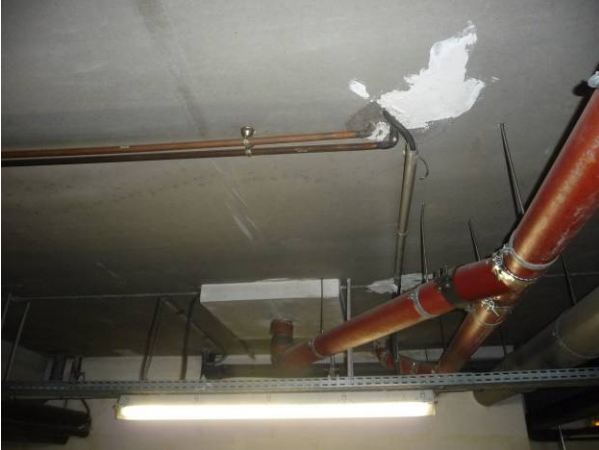
Alimentations EF et ECS existantes en plafond du parking
