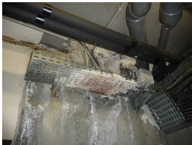
Vidanges en plafond du parking
