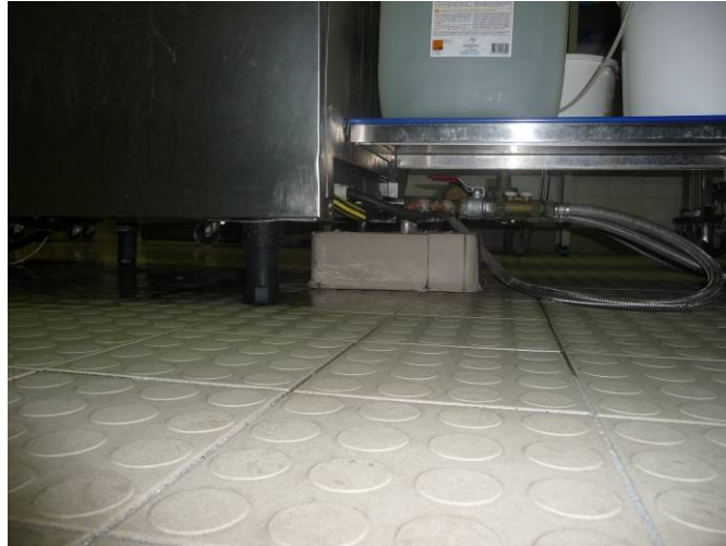
Alimentation eau chaude existante
