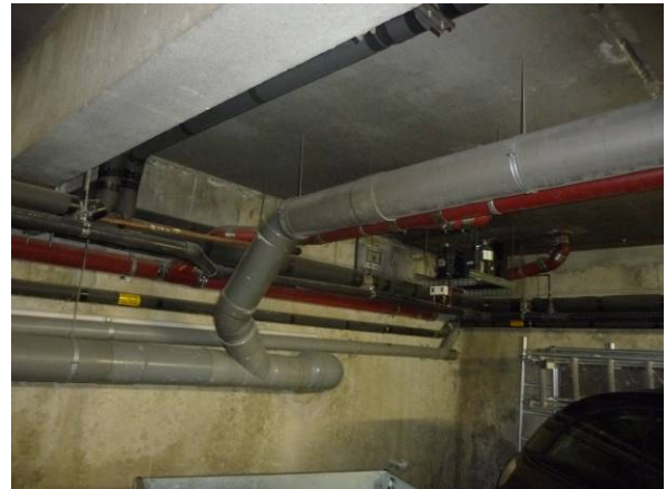
Collecteurs existants en plafond du parking
