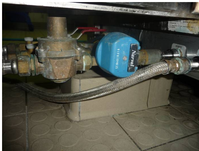
Alimentation eau froide existante
