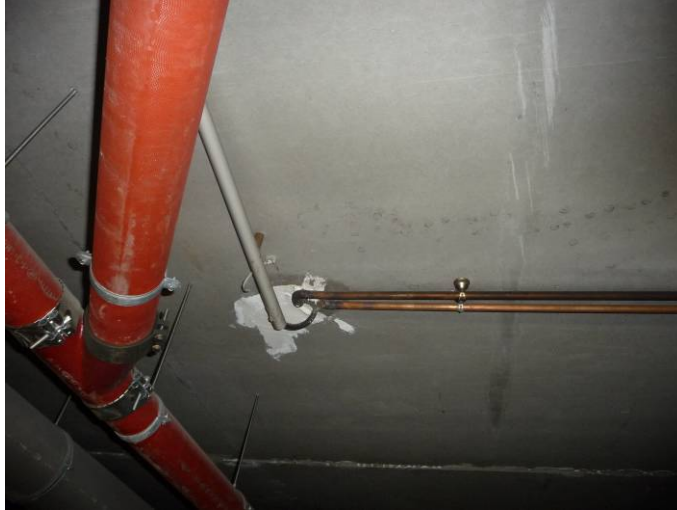
Collecteur fonte existant en plafond du parking
